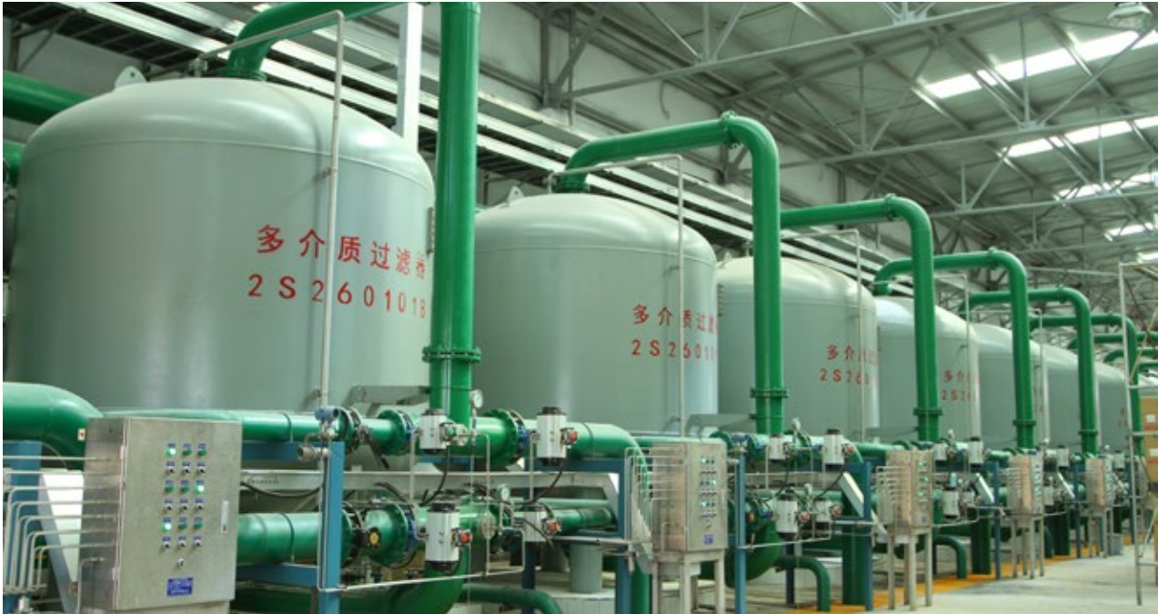
鄂能化公司废水处理装置，可有效处理废水中的杂质，处理量为 1200 吨 / 小时。
