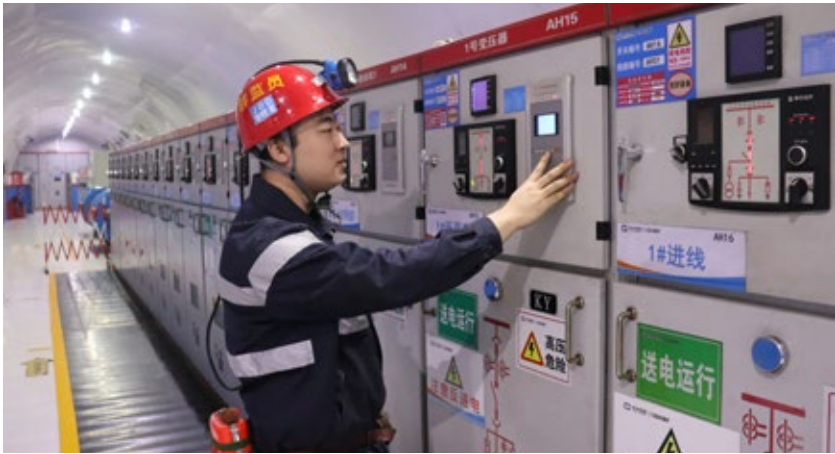
春节期间，中国中煤中天合创门克庆煤矿群监员坚守岗位，检查井下电气设备
